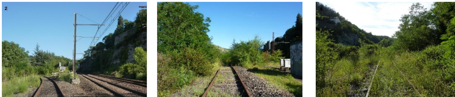
Etat de la voie ferrée au niveau de la bifurcation de Cahors vers Capdenac
